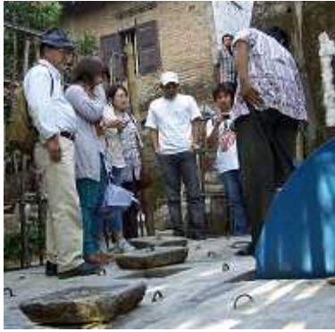
クリチャック地区の排水処理施設
