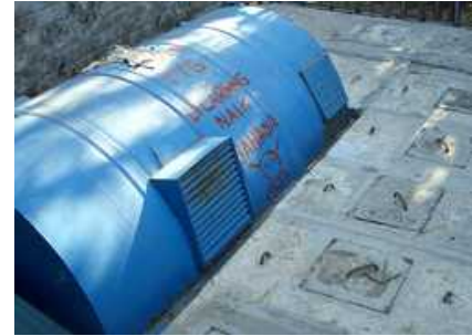
排水処理設備は住民が管理・運営している
