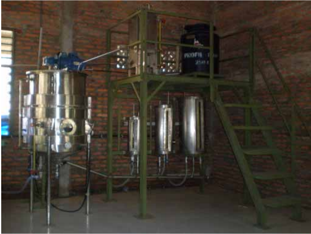
写真 13. ワイリタ地区に設置された小規模精製設備(2009年10月9日)
